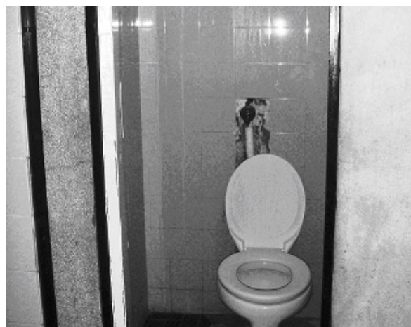
Figura 3. Box sanitário com porta estreita, ausência de barras de apoio, e espaço insuficiente para manobra e transferência da cadeira insuficiente.
