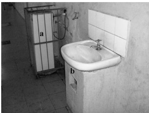
Figura 2. a: bebedouro com altura e grade inadequadas; b: lavatório com torneira do tipo giratória e inexistência de espaço inferior para aproximação da cadeira.
